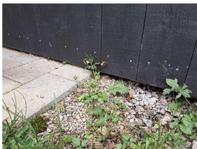
Utvendig - [Liten klaring mellom terreng og kledning]
