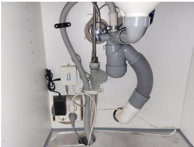
Kjøkken - [Rørøpplegg i kjøkkenbenk]
