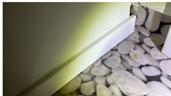
Gulvlister i våtzone er feil. Belegg burde vært brettet opp.
