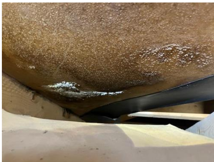
Loft - uinnredet / råloft - [Fuktskader i undertak]
