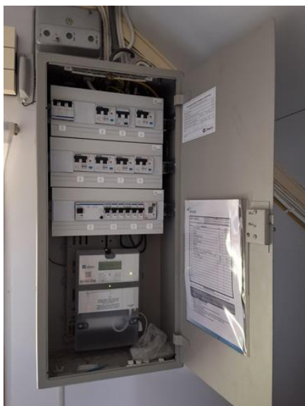
Elektrisk anlegg - [Sikringskap på gang i 2. etasje]
