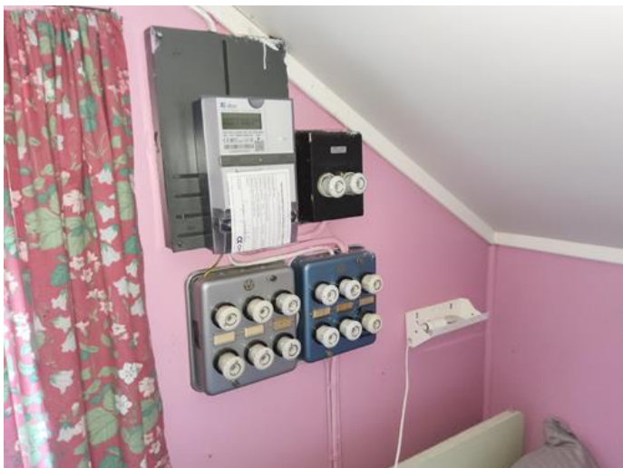
Elektrisk anlegg - [Sikringsbokser.]
