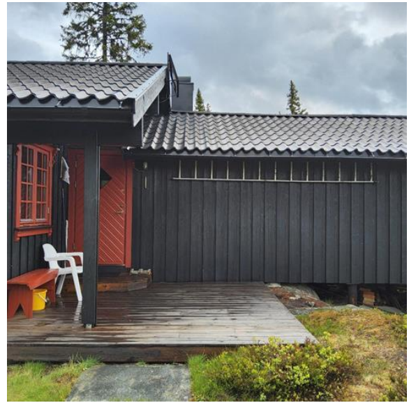
Utvendig - [Manglende snøfangerutstyr over inngangsparti]
