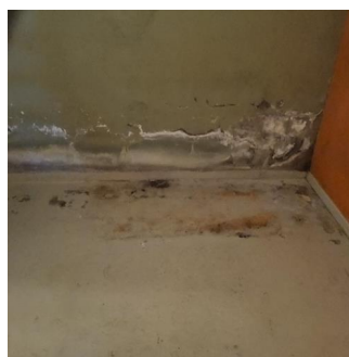
Helhetsvurdering - Eksempel på fuktproblematikk og salt-/kalkutslag
