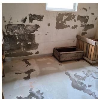
Helhetsvurdering - Eksempel på slitasjer og fuktproblematikk
