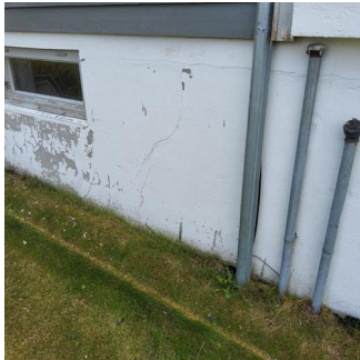
Grunnmur og fundament - Eksempel på sprekker og slitasjer på grunnmur
