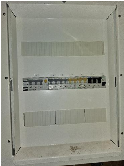
Elektrisk anlegg - [Fordeling, låven]
