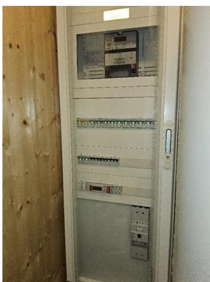
Elektrisk anlegg - [Sikringsskap, låven]
