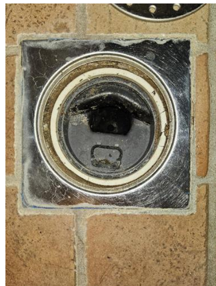
Avløpsrør (ink. sluk) - [Sluk, bad 2 enebolig]
