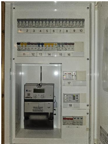
Elektrisk anlegg - [Sikringsskap]
