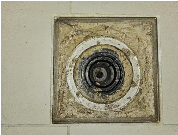
Avløpsrør (ink. sluk) - [Sluk, bad 1 enebolig]
