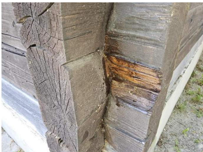
Fasader ink. kledning - [Råteskadet lafteknute]
