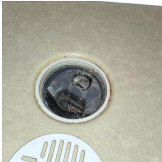
Avløp (inkl. sluk) - Sluk under vask
