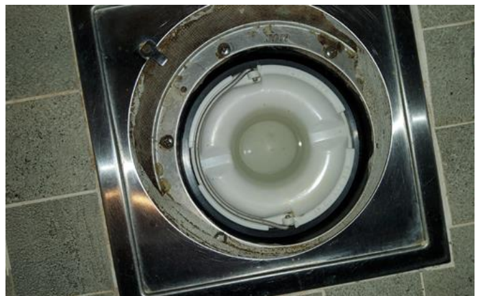
Avløpsrør (ink. sluk) - [Sluk bad ved soverom.]
