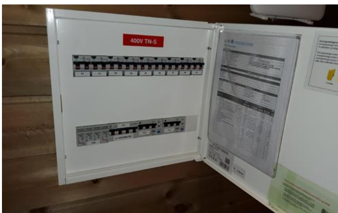
Elektrisk anlegg - [Sikringsskap med kursfortegnelse.]
