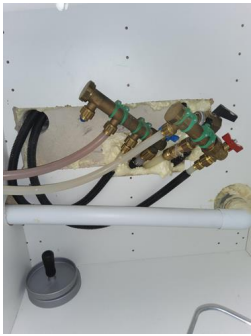
Fordelerskap og fordelersstammer - Fordelersstammer
