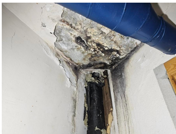
Eldre fuktskade etter tidligere lekkasje.
