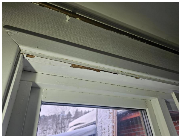
Fremdeles lekkasje i vinduspost i gang mellom kjøkken og frokostsal.
