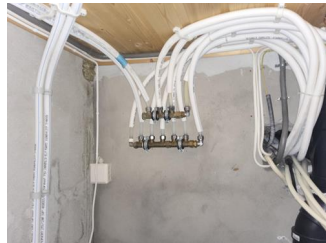
Fordelerskap og fordelerstammer - Fordelerstammer for rør-i-rør.
