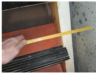
Rekkverk og håndløper - Avstand mellom trappevange og vegg.
