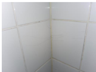
Overflater vegger - Riss i fliser i dusjsonen.
