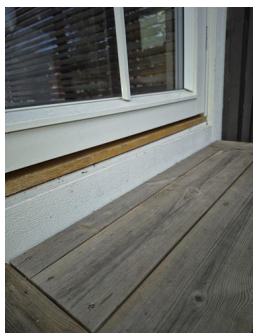
Ytterdører og omramming - Manglende beslag under terrassedør.
