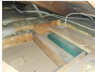
Annet - Manglende isolasjon over downlightskasse.
