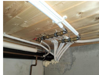
Fordelerskap og fordelerstammer - Fordelerstammer for rør-i-rør.
