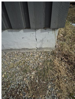
Grunnmur og fundament - Eksempel på sprekkdannelse i grunnmur.
