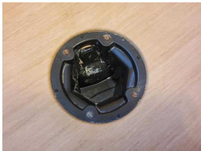
Helhetsvurdering - [Sluk bad 1.etasje]
