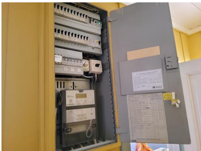
Elektrisk anlegg - [Sikringsskap]
