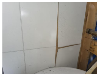
Overflater vegger - Eksempel på skader i baderomsplater.
