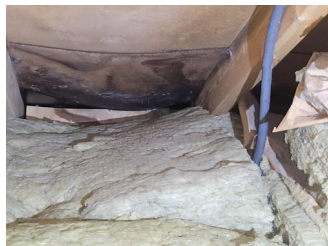
Synlige overflater (taktro, vegger, gulv, o.l) - Fuktskader i undertaksplate.
