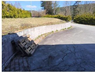
Rekkerkshøyde og lysåpninger - Støttemur ved innkjørsel/gårdsplass med manglende rekkverk på toppen.
