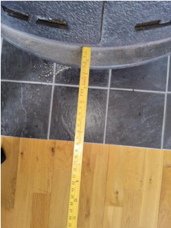
Ildsteder - For liten avstand fra ildsted til brennbart materiale i fremkant.
