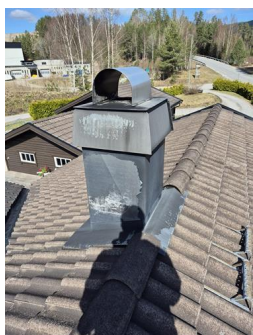
Tekking (med tilhørende beslag) - Slitasje på pipebeslag.
