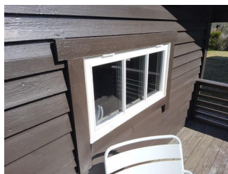
Vinduer, dører og porter - Eksempel på manglende vannbrett over og under vinduer.
