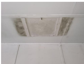
Innvendige forhold - Fuktskjolder ved luke til kryploft.
