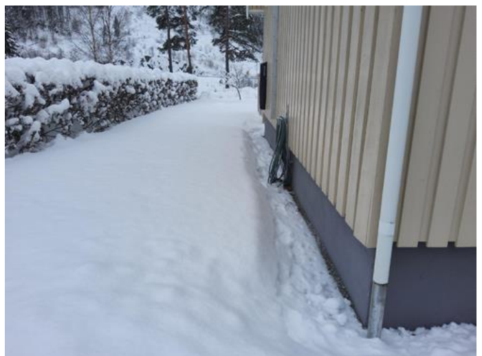
Terrengfall fra grunnmur - [Eksempel på snødekket terreng rundt boligen. ]
