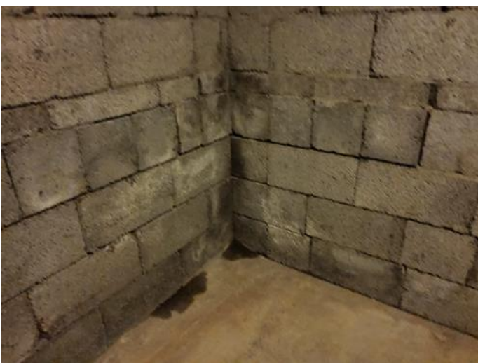
Annet - [Fuktskjolder på vegg i uinnredet rom i kjeller.]
