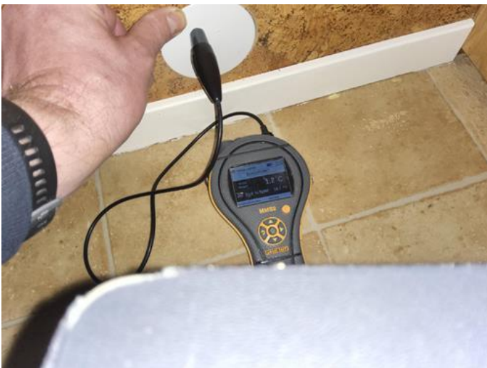
Fukt i tiliggende konstruksjoner - [Fuktmåling i vegg mot vaskerom. ]
