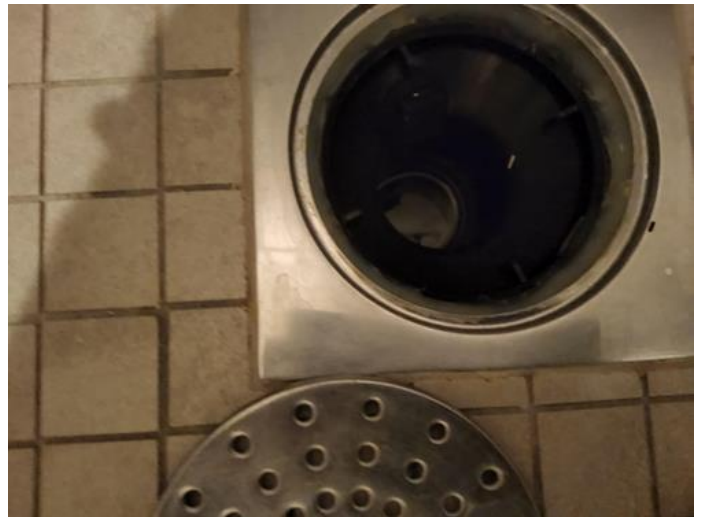
Avløpsrør (ink. sluk) - [Sluk på bad i kjeller.]
