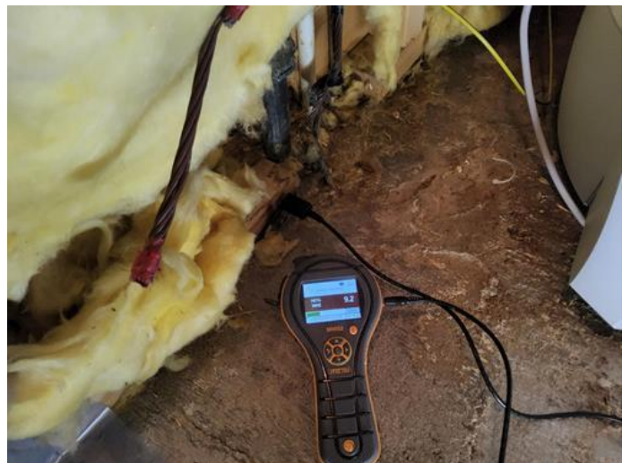
Fukt i tilliggende konstruksjoner - [Fuktmåling i badevegg på bad i kjeller.]
