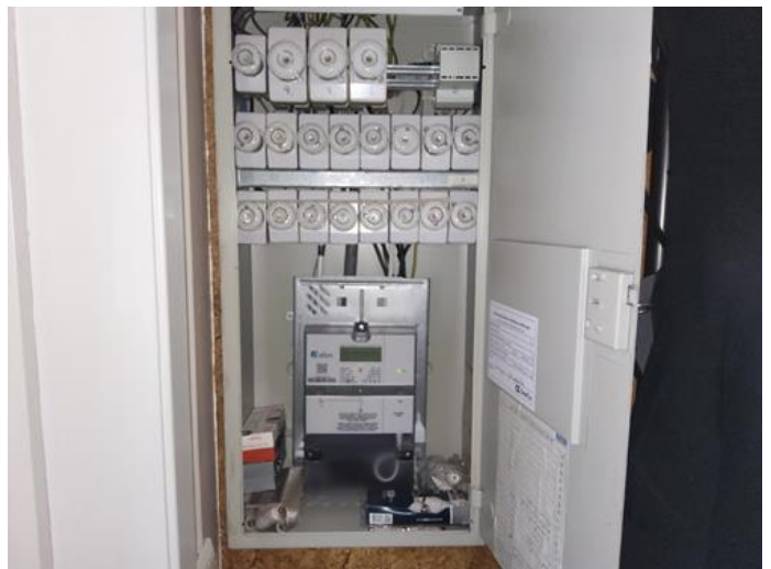
Elektrisk anlegg - [Sikringskap. ]
