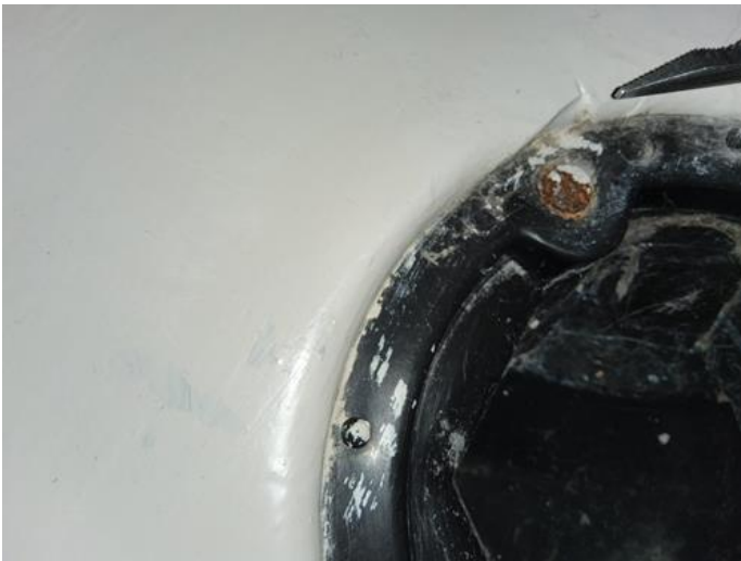
Membran, tettesjikt og overgang til sluk. - [Skade i gulvbelegg ved sluk.]
