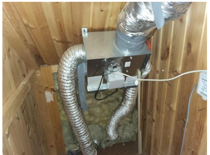
Ventilasjon - [Sentralvifte plassert i kott i 2.etasje.]
