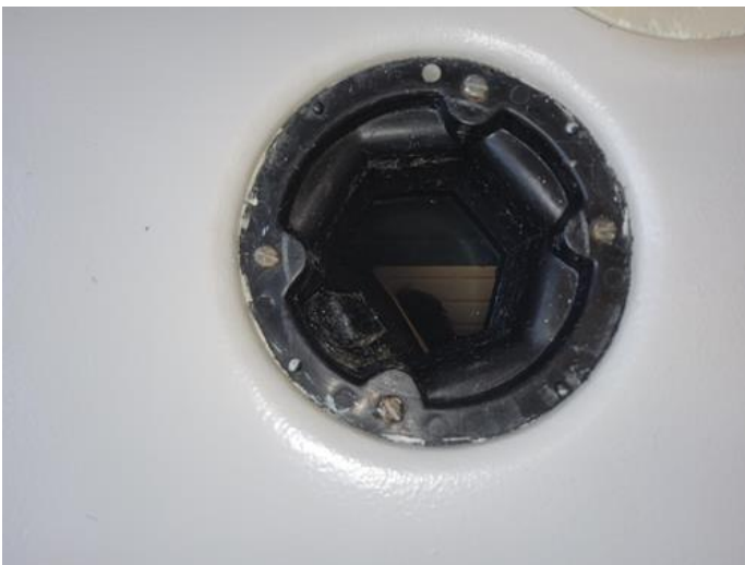
Avløpsrør (ink. sluk) - [Sluk på bad 1.etasje.]
