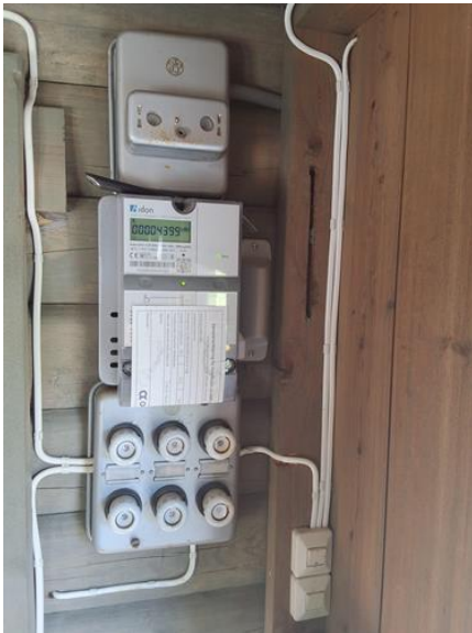
Elektrisk anlegg - [Sikringskap i entre.]
