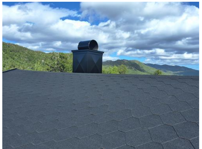
Utvendig - [Nedbøy i takflate]
