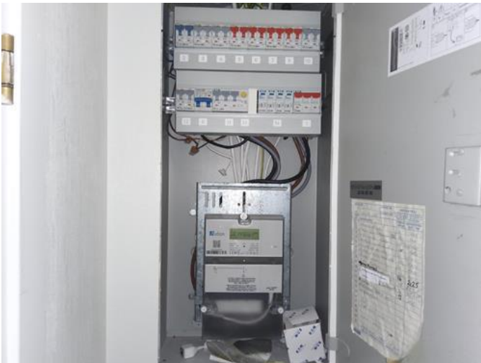
Elektrisk anlegg - [Sikringskap.]
