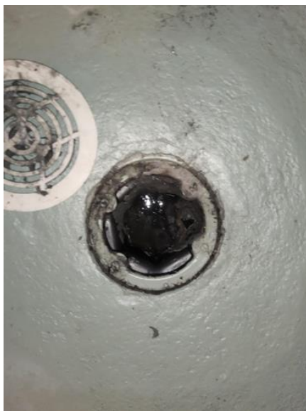
Våtrom - [Sluk på vaskerom.]
