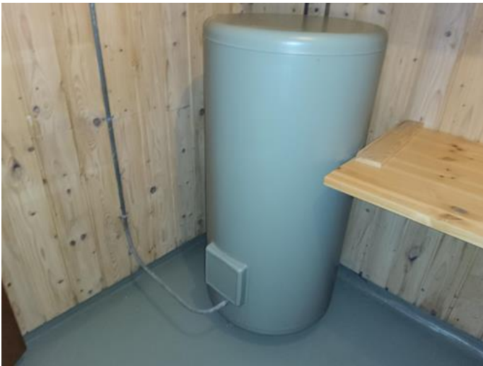
Varmtvannsbereeder (Sjekkpunkter utover det som er inkludert i andre rom) - [Varmtvannsbereeder.]
