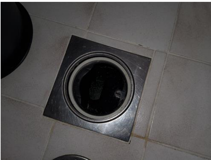
Kommentar - [Sluk bad 1.etasje]
