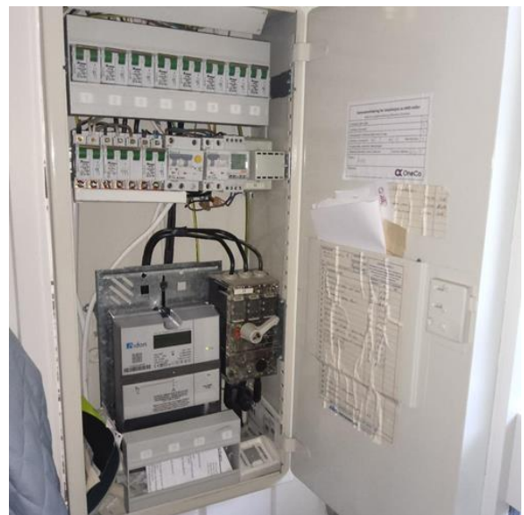
Elektrisk anlegg - [Sikringsskap og kursoversikt ]
