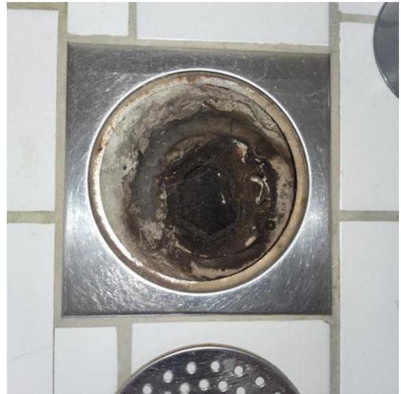
Våtrom - [Sluk bad 1.etasje ]
