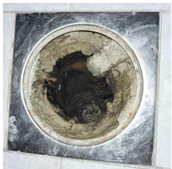
Våtrom - [Sluk bad kjeller ]
