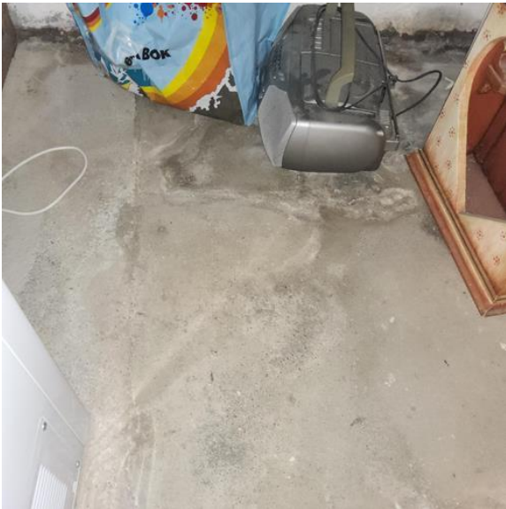
Innvendig - [Eksempel på fuktmerker, salt-/kalkutslag i kjellerbod]
