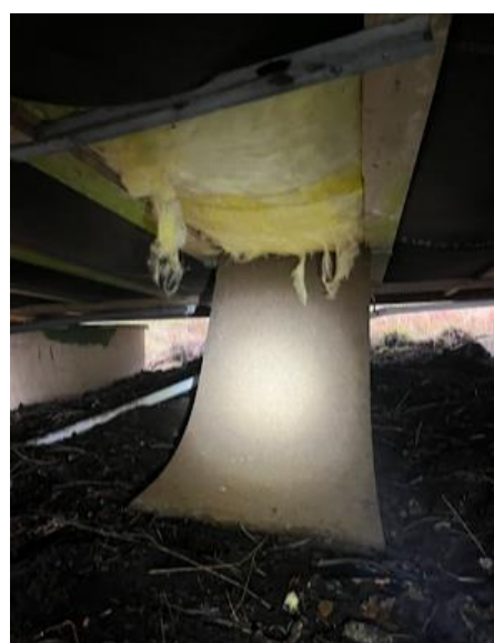
Fundamenter - [Løse stubbloftsplater. ]
