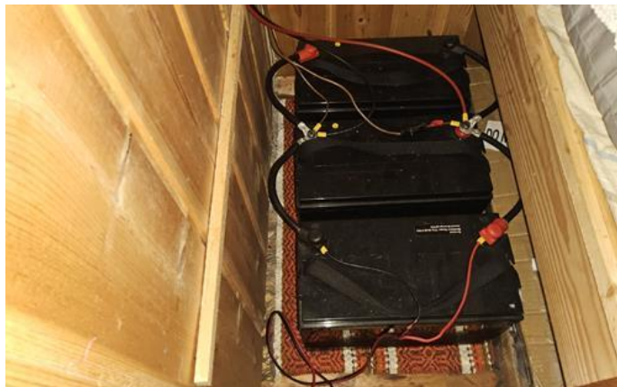
Elektrisk anlegg - [Batteri til solpanel.]
