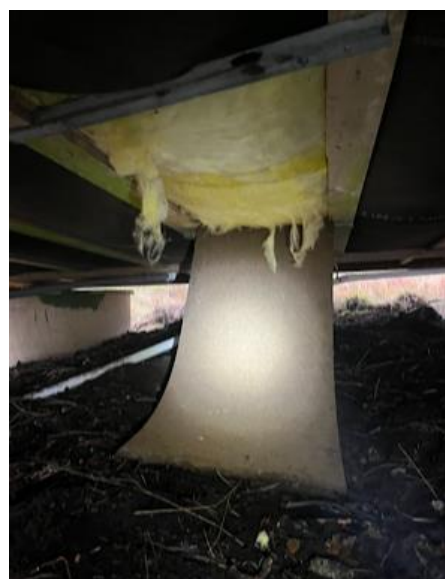
Fundamenter - [Løse stubbloftsplater. ]
