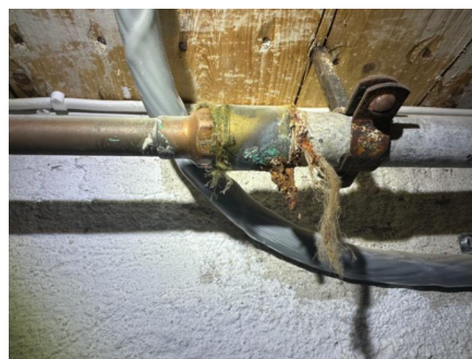
Rust/korrosjon i rør skjøt.
