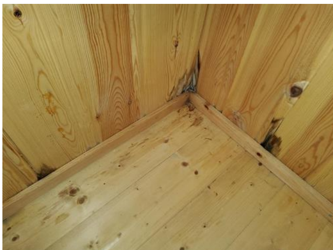
Kommentar - [Eksempel på fuktmerker i underetasjen]
