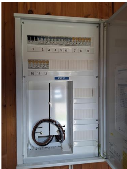
Elektrisk anlegg - [Sikringskap 1. etasje Tyrlivegen 13 ]
