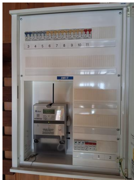
Elektrisk anlegg - [Sikringskap 2. etasje Tyrlivegen 13]
