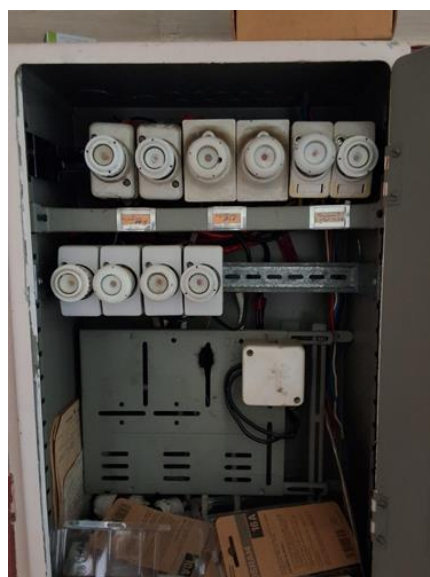
Elektrisk anlegg - [Sikringskap Tyrlivegen 15 ]
