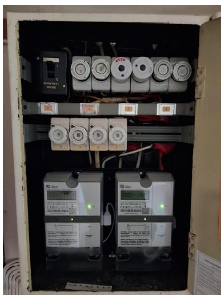
Elektrisk anlegg - [Sikringskap Tyrlivegen 15]
