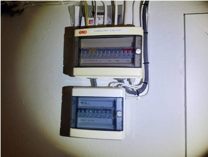
Beskrivelse - [Sikringskap kjeller]
