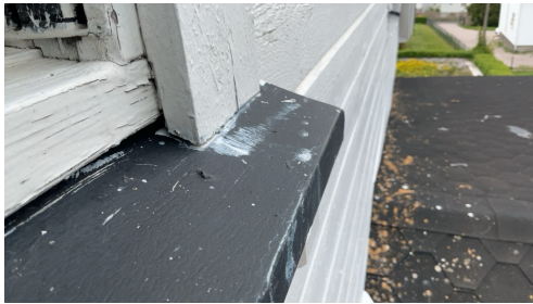
Vindusomramming står i kontakt med underbeslaget.
