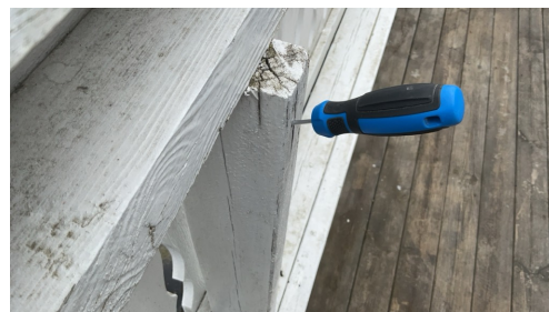
Råte i rekkverk
