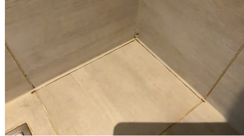
Mykfug i dusjsone har løsnet
