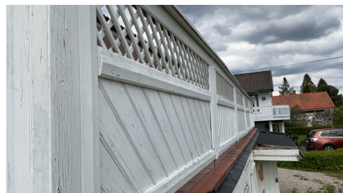
Det er etterslep på vedlikehold
