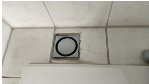
Sprekk i flis
