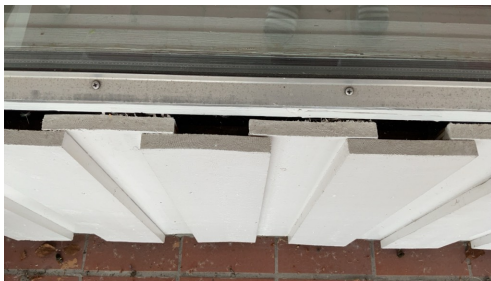
Det er påvist avvik rundt innsettsdetaljer.
