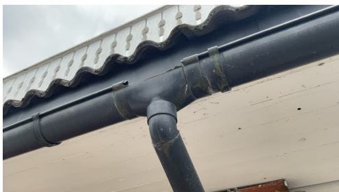
Sprekk i takrenne
