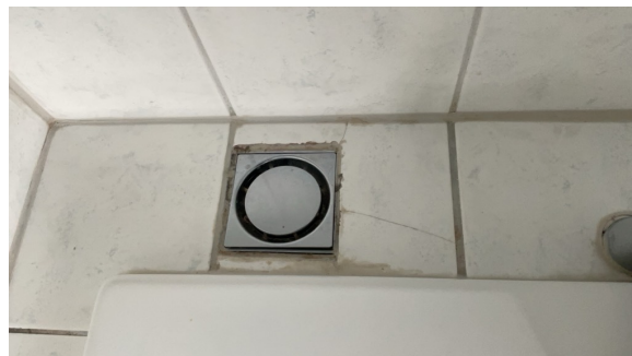
Sprekk i flis
