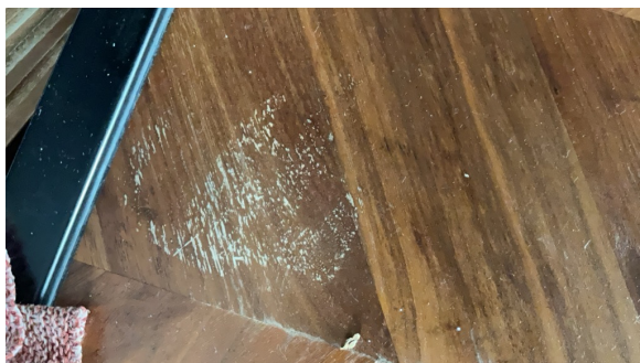
Slitemerker på benkeplate
