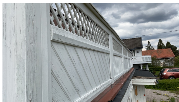
Det er etterslep på vedlikehold
