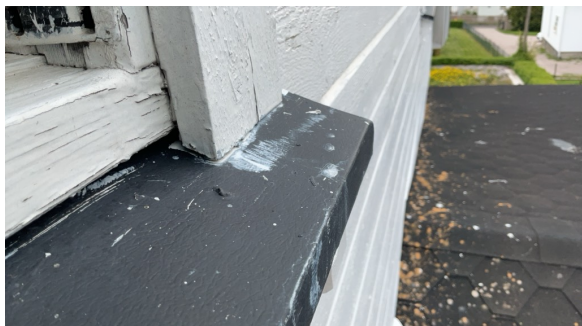
Vindusomramming står i kontakt med underbeslaget.
