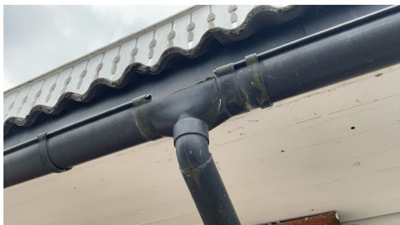
Sprekk i takrenne
