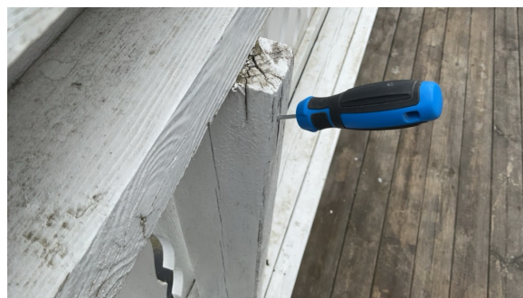
Råte i rekkverk
