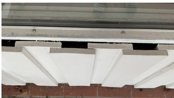
Det er påvist avvik rundt innsettsdetaljer.
