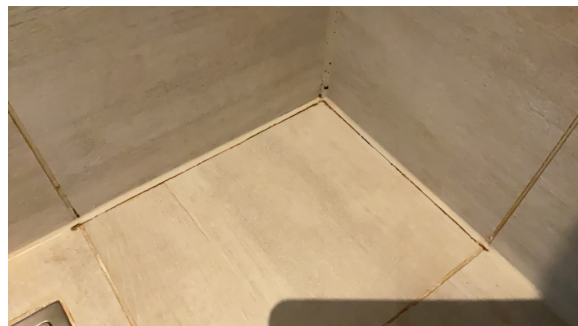
Mykfug i dusjsone har løsnet
