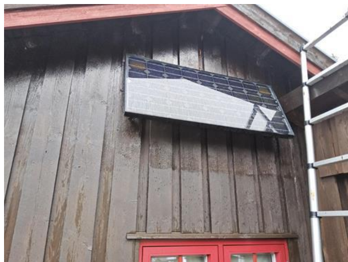
Elektrisk anlegg - [Solcellepanel]
