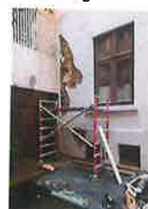
Manglende takrennene nabogårdens side av bygget over skadestedet
