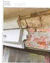
Store skader ved fjerde etasje
