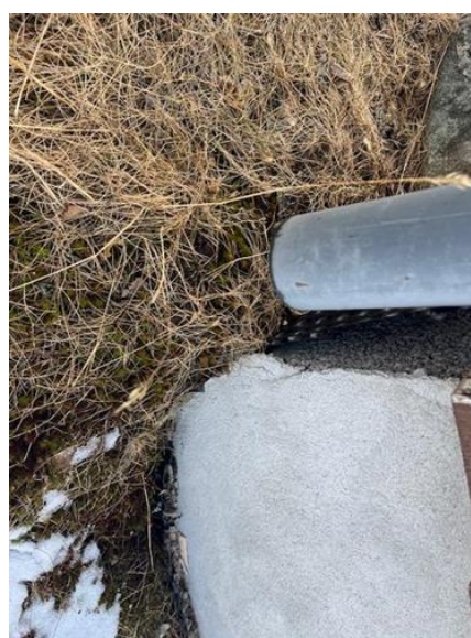
Drenering - [Mangelfull bortledning av takvann]
