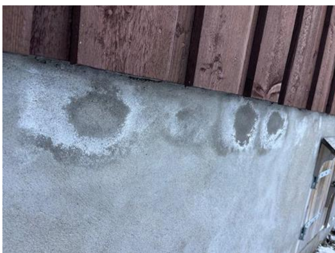
Drenering - [Fuktmerker på grunnmur]
