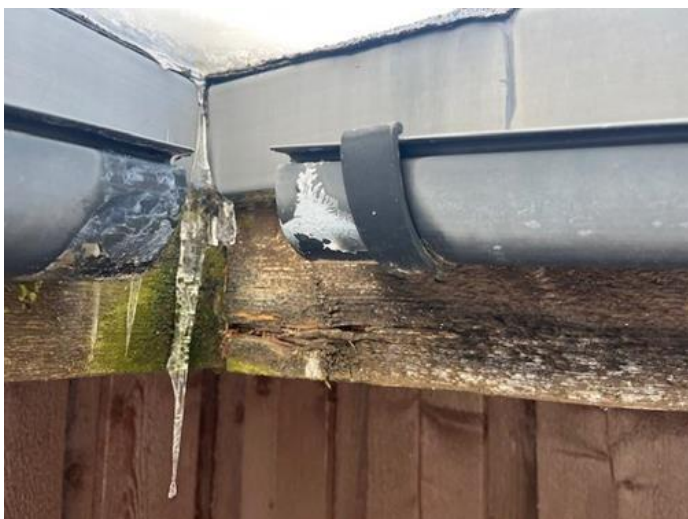
Kommentar - [Eksempel på skader takrenner/forkantbord]
