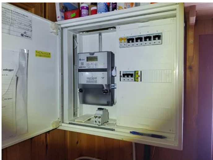
Elektrisk anlegg - [Sikringsskap]
