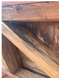
Helhetsvurdering - Fuktskader i undertak
