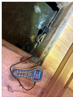
Overflate gulv - Fuktmåling og råteskader i luke på kjøkken
