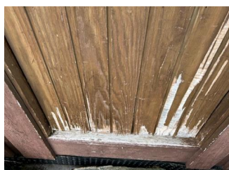
Ytterdører og omramming - Skader på ytterdør
