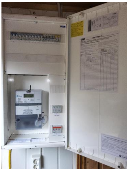
Elektrisk anlegg - [Sikringsskap og kursoversikt]
