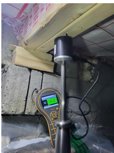
Krypekjeller - [Fuktmålinger i krypkjeller]
