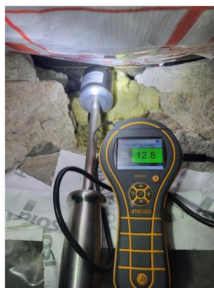
Krypekjeller - [Fuktmålinger i krypkjeller]
