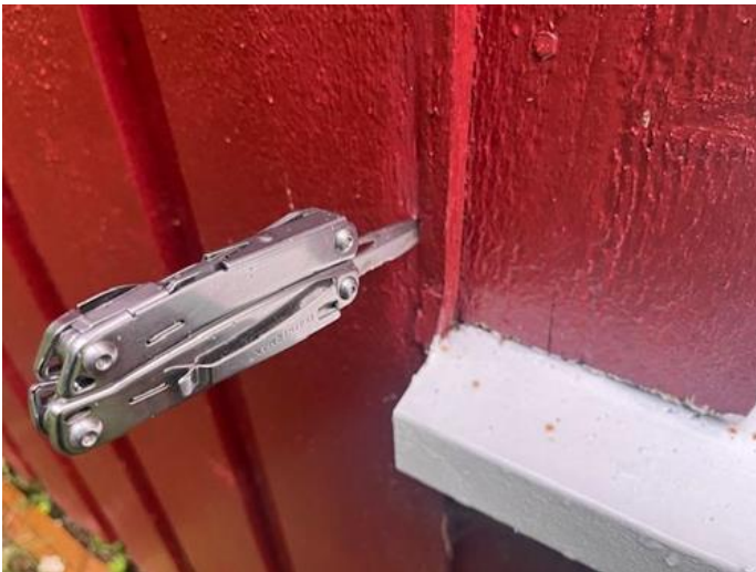
Kommentar - [Eksempel på råteskader]
