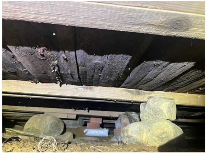
Helhetsvurdering - [Eksempel på råteskader i krypekjeller]
