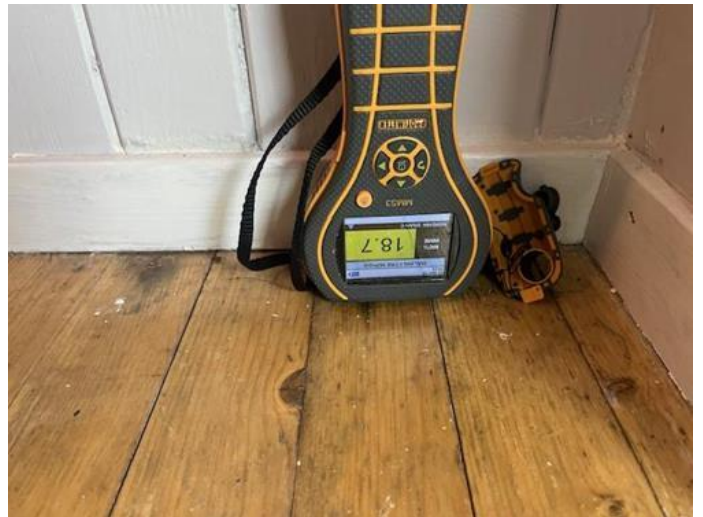
Øvrige rom [eksklusive spesialrom] - [Fuktmåling i entregulv]
