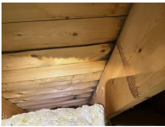
Konstruksjonsoppbygging - Fuktmerker på kneloft
