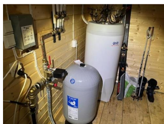
Vannrør (utover det som nevnes under andre sjekkpunkter) - Teknisk anlegg
