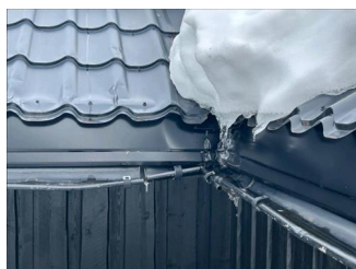
Takrenner og utvendige nedløp - Skader på takrenner og takplater
