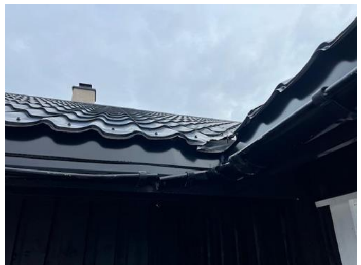
Beskrivelse - [Eksempel på skader takrenne]
