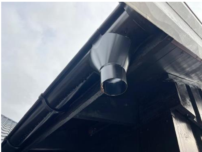
Beskrivelse - [Manglende nedløp]
