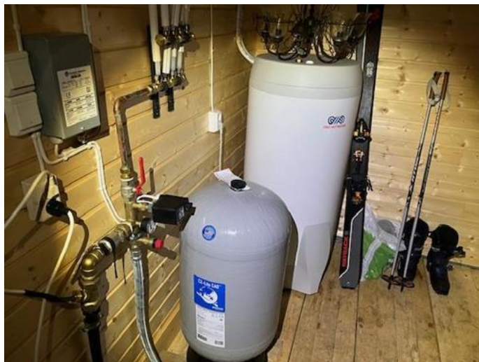
Beskrivelse - [Teknisk anlegg]
