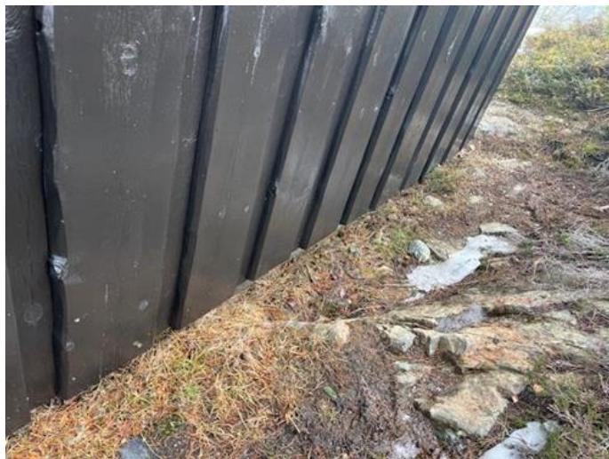
Beskrivelse - [Fall mot grunnmur]
