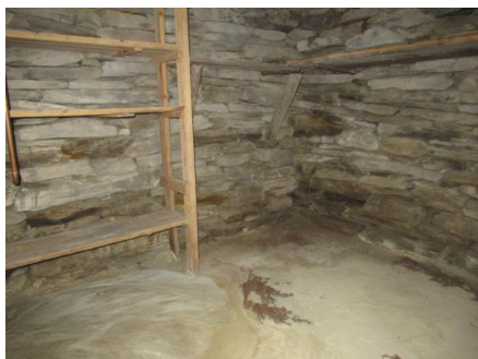
Slam på gulv i kjeller.
