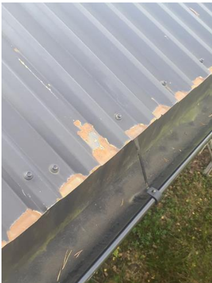
Yttertak - [Rust på takplater.]
