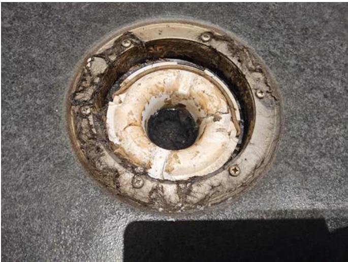
Avløpsrør (ink. sluk) - [Sluk baderom]
