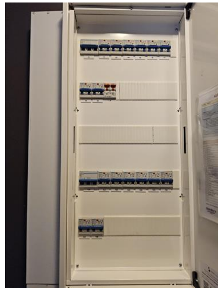
Elektrisk anlegg - [Sikringskap]
