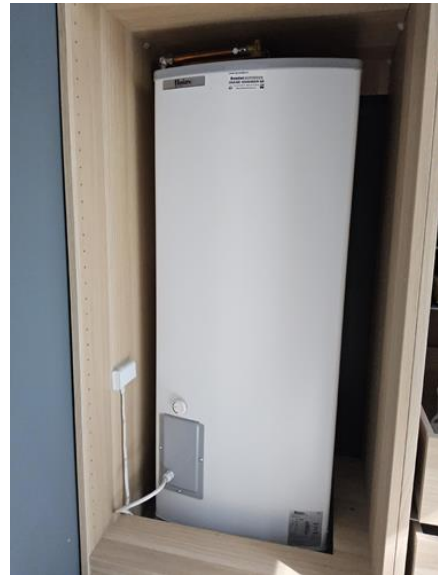
Varmtvannsbereider (Sjekkpunkter utover det som er inkludert i andre rom) - [Varmtvannsbereider]
