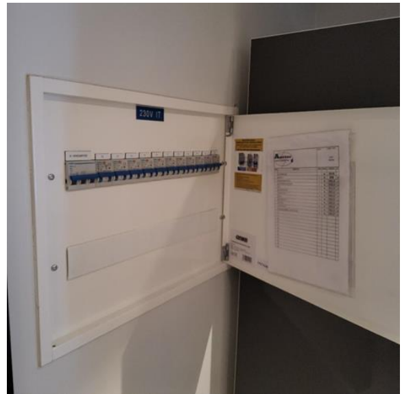
Elektrisk anlegg - [Sikringskap og kursoversikt plassert i soverom i kjeller]
