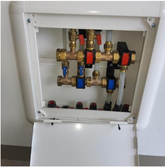
Tekniske anlegg, VVS anlegg (Sjekkpunkter utover det som er inkludert i andre rom) - [Fordelerskap for rør-i-rør system plassert i garasje]
