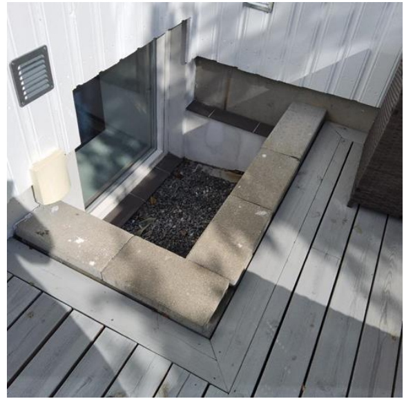
Utvendig - [Lyskasse på platting]
