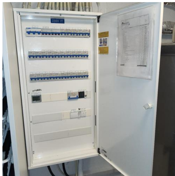
Elektrisk anlegg - [Sikringskap og kursoversikt plassert i teknisk rom]
