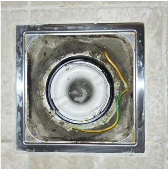
Avløpsrør (ink. sluk) - [Sluk bad kjeller]
