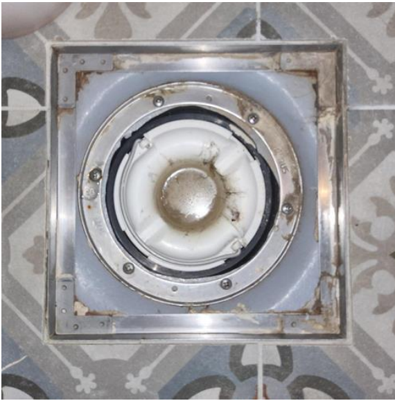
Avløpsrør (ink. sluk) - [Sluk bad 1.etasje ]
