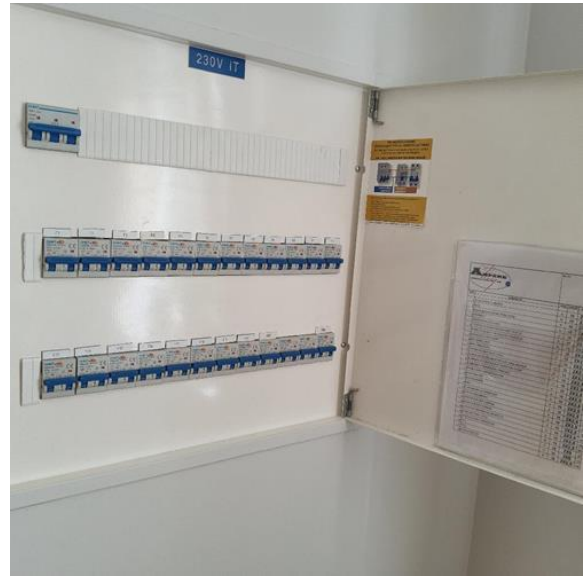
Elektrisk anlegg - [Sikringskap og kursoversikt plassert i stue mot bad 1.etasje ]
