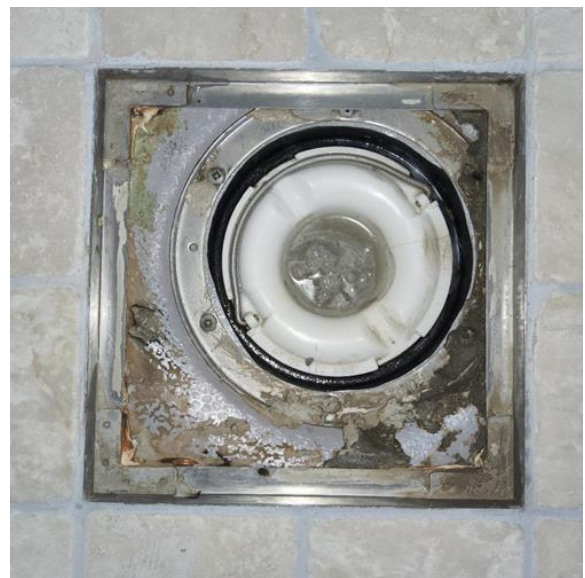
Avløpsrør (ink. sluk) - [Sluk dusjsonen bad 2 i 2.etasje ]
