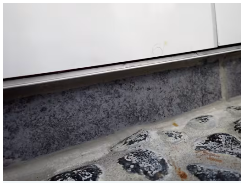
Manglende silikon mellom plate og bunnlist
