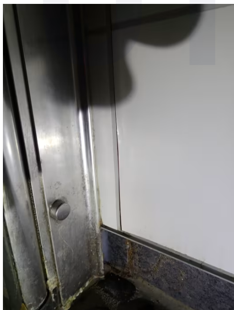
Skade i skjøt
