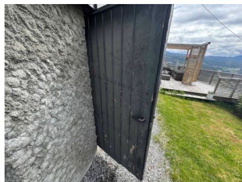
Kjellerdører med råte
