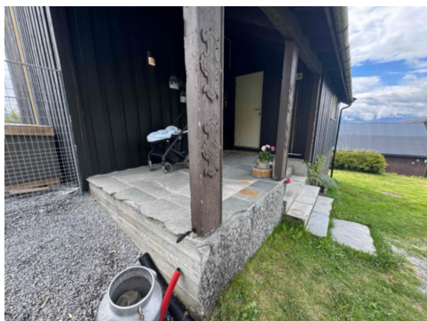
Skader på skifer og råte i søyle
