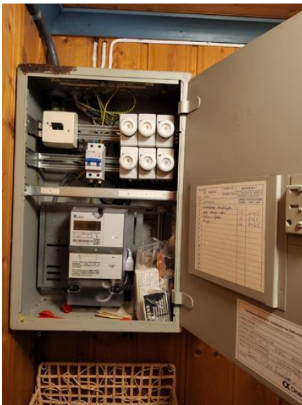
Elektrisk anlegg - [Sikringskap i entre]
