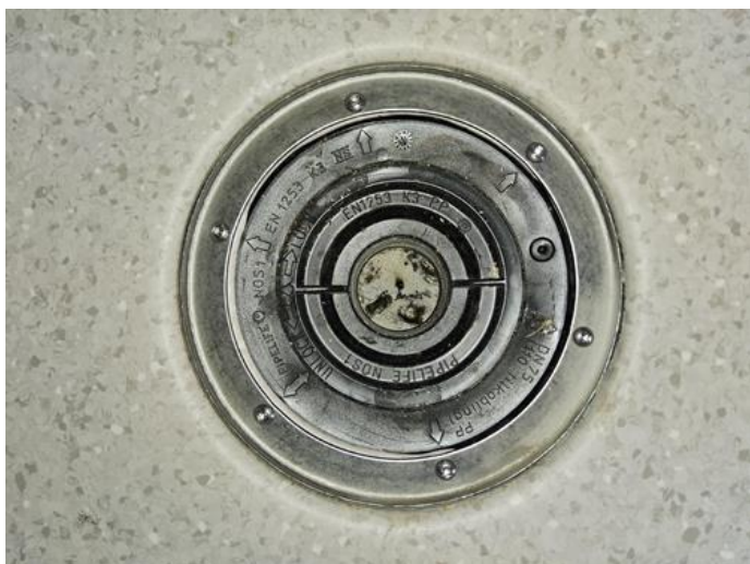
Avløpsrør (ink. sluk) - [Sluk gjestebad]
