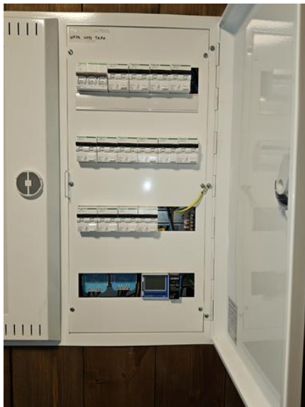
Elektrisk anlegg - [Sikringsskap]
