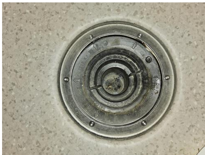
Avløpsrør (ink. sluk) - [Sluk hovedbad]
