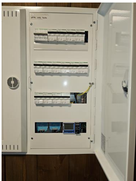
Elektrisk anlegg - [Sikringsskap]
