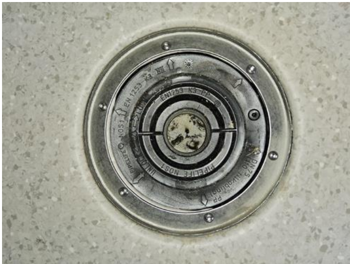
Avløpsrør (ink. sluk) - [Sluk gjestebad]
