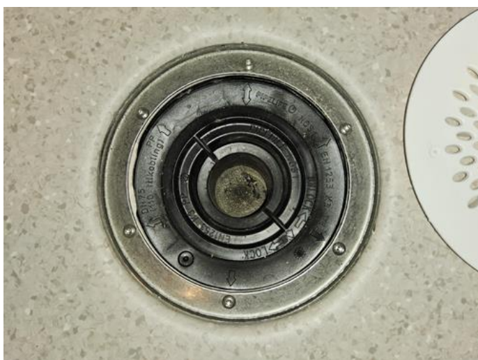
Avløpsrør (ink. sluk) - [Dusjsluk hovedbad]
