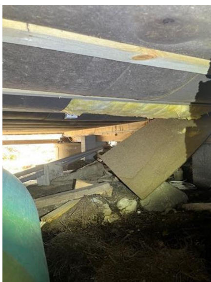
Grunnmur, fundamenter - [Løse stubloftsplater. ]
